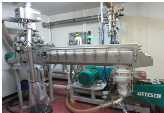
Figure 2 : Installation CONDUX 300 de Netzsch à SDTech
